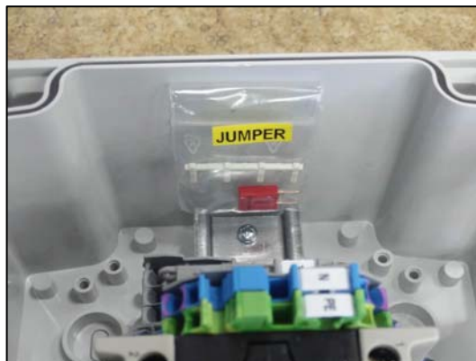
Pribalený mostík a záslepka v rozvodnej krabici
