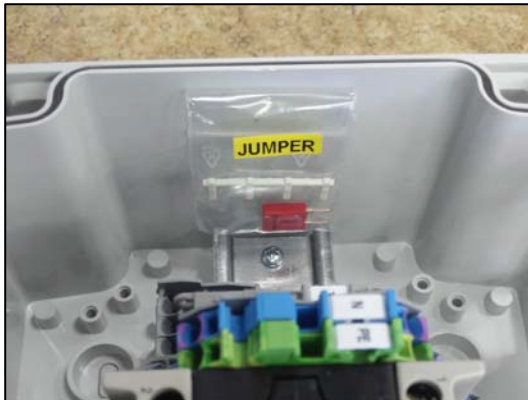
Перемычка и заглушка в электромонтажной коробке.
